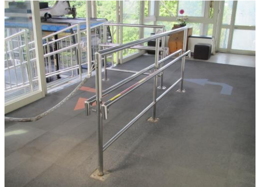
手すり（日本平駅ホーム付近）
